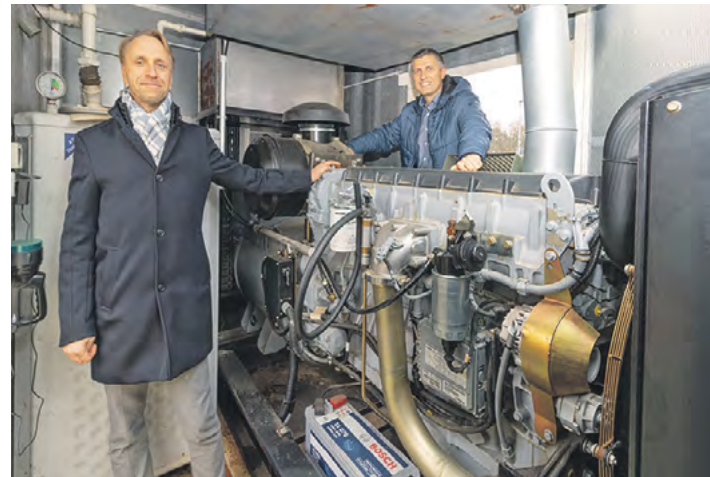
Fuhrparkleiter Sven Schulze (li.) und Steffen Grünheid, Bereichsleiter Technik, überzeugen sich vom ordnungsgemäßen Zustand der stationären Notstromanlagen.
