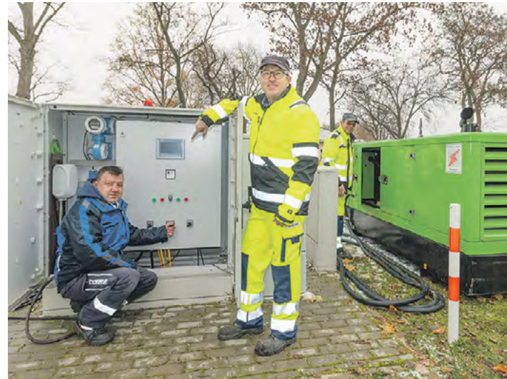
Betriebselektroniker Ingolf Lamprecht (li.) und Vorarbeiter Mario Halpap schließen ein mobiles Notstromgerät an ein Pumpwerk an und prüfen, ob alles funktioniert.
