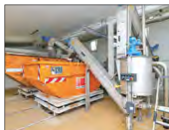
Der alte Sandfang ist noch immer für nur 33.000 Einwohnerwerte ausgelegt. Die Erweiterung bringt ihn auf 49.666 Einwohnerwerte.
