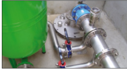
Die blitzblanke Brunnenstube der neuen dritten Wasserfassung.
