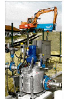
Die neue Fäkalannahmestation in Zossen soll im Laufe dieses Monats in Betrieb gehen.
