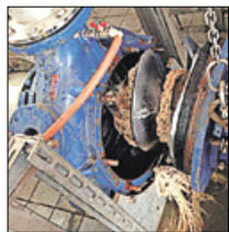
Auch das Hauptpumpwerk Waltersdorf wurde durch Feuchttücher im Betrieb gestört. Kosten der Störungsbeseitigung: rund 800 Euro!
