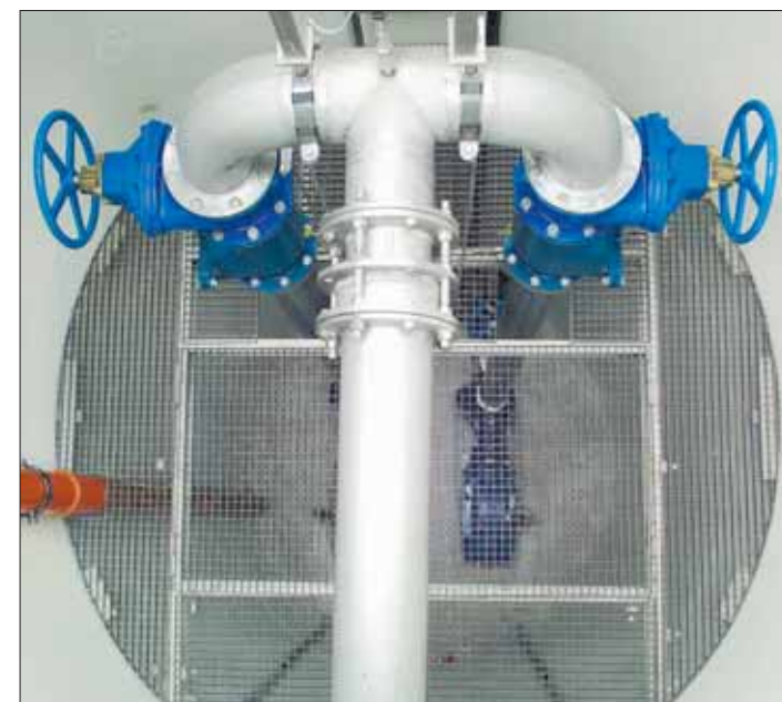
Ein Blick in das Herz der vollständig sanierten Pumpstation.
