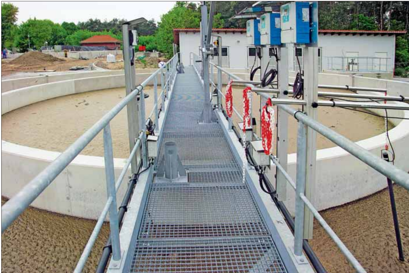
Das Belebungsbecken für die biologische Reinigung des Abwassers in Zossen hat bereits Fahrt aufgenommen.
