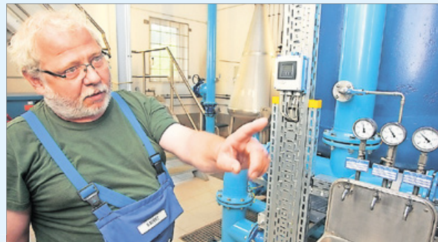
Wasserwerker Wolfgang Kuert erklärt den Nutzen der neuen Filterspülvorrichtung. Über die Monitore der Leitwarte (links) wird der Prozess der Trinkwasseraufbereitung überwacht.
