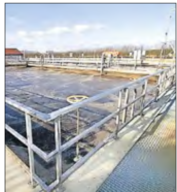
Auch hier gilt: alles paletti! Im Belebungsbecken beginnt die biologische Phase der Reinigung.
