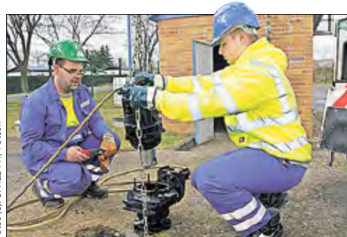
So geht's – Jonas Reimann (rechts) beim Säubern einer Schmutzwasserpumpe in Ludwigsfelde unter Anleitung des erfahrenen Kollegen André Höhne.
