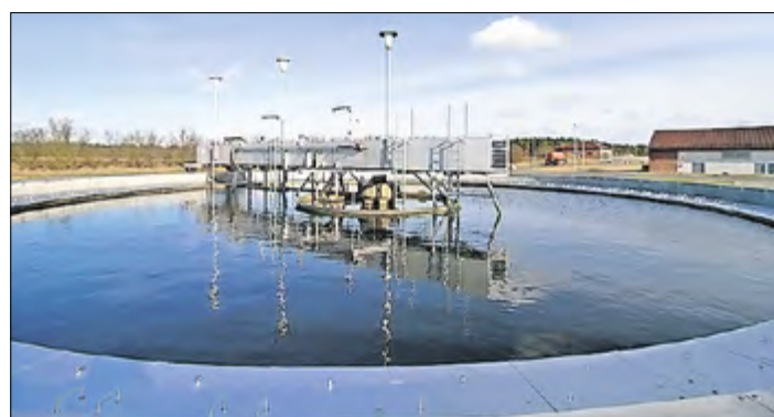
Das Nachklärbecken mit dazugehöriger Räumbrücke strahlt in neuem Glanz – siehe hierzu auch „Wasserchinesisch“ unten.
