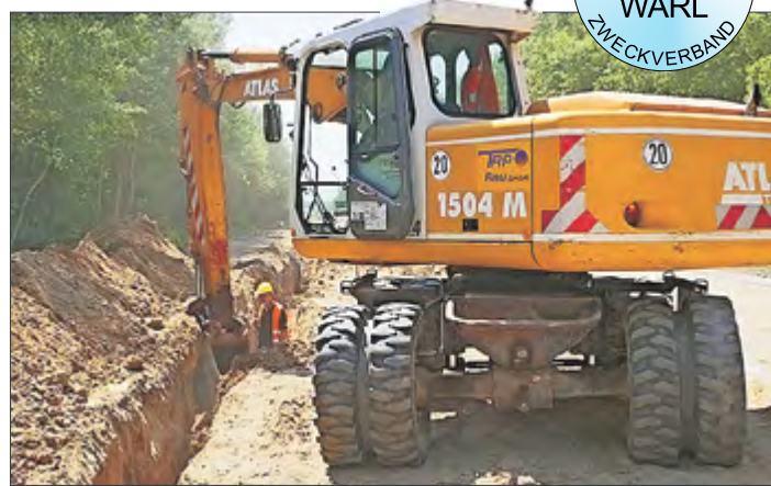
Hier wird geklotzt, nicht gekleckert. Die Trassenführung der Ver- und Entsorgungsleitungen fürs neue Gewerbegebiet Eichspitze.
